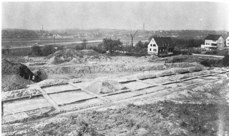
Abb. 5. Die Aufnahmen zeigen den Zustand von Fläche 1 während der Grabungen 1966. a: Sicht auf Fläche 1 nach Nordosten. – b: Sicht auf Fläche 1 nach Nordwesten mit Blick ins Ruhrtal.
